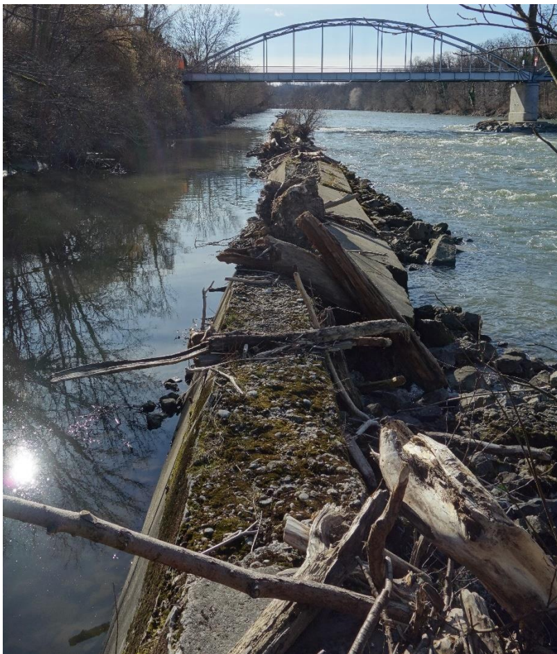
Slika 7: deloma podrt delilni zid med strugo Mure in natočnim kanalom na vtoku (foto: Gašper Zupančič, 27. 2. 2020).
