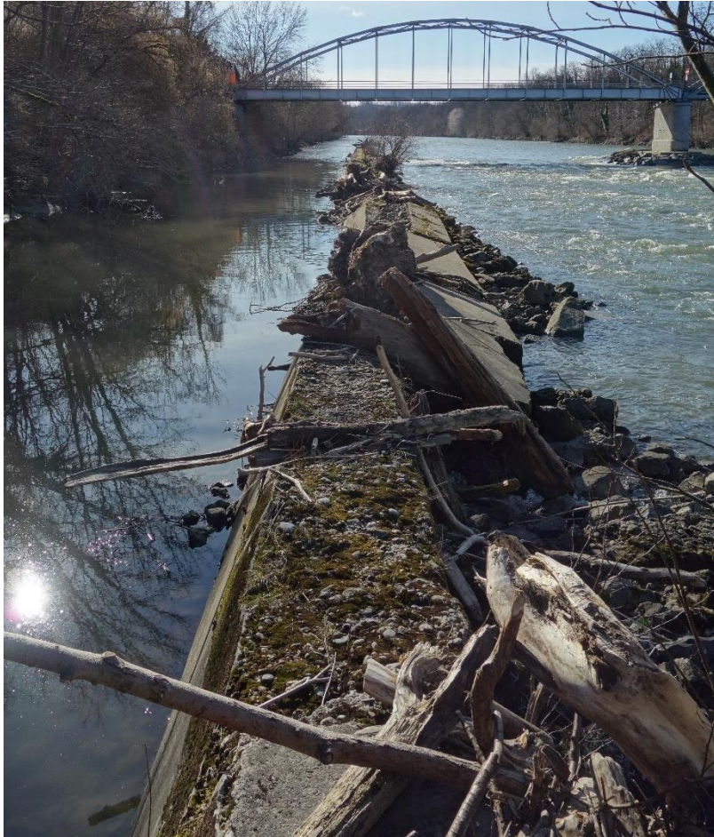
Bild 7: Teilweise eingestürzte Wand zwischen dem Gerinne der Mur und dem Einlaufkanal (Foto: Gašper Zupančič, 27. 2. 2020).
