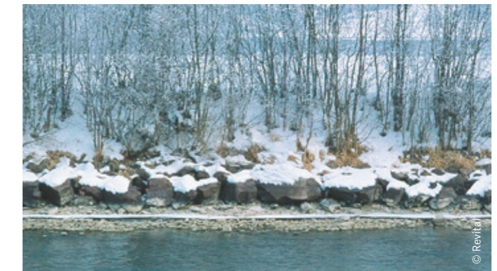
Abb. 3: Fortschreitende Sohleintiefung kann Ufersicherungen unterkolken / Slika 3: Poglobljanje dna lahko spodjeda obrežna zavarovanja
